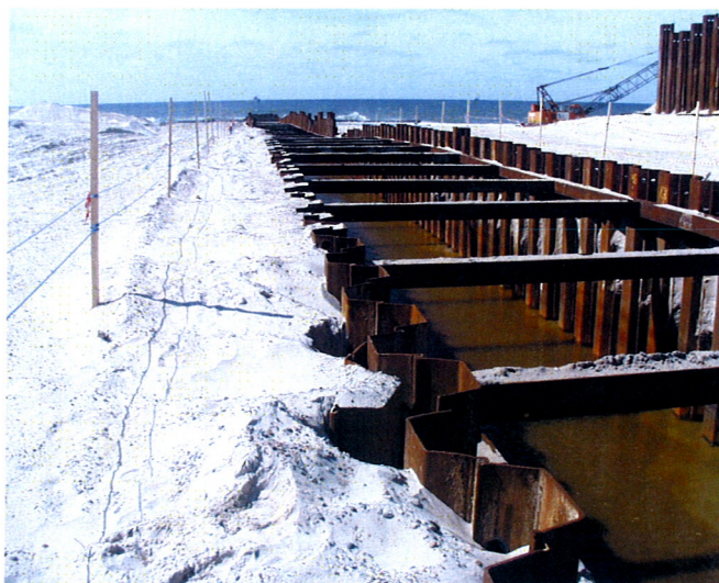
Rysunek 1-3 Przykład grodzi uszczelniającej do wciągnięcia rurociągu na ląd (©DONG: South Arne - Nybro, budowa podmorskiego rurociągu 24", lata 1997-1999).
